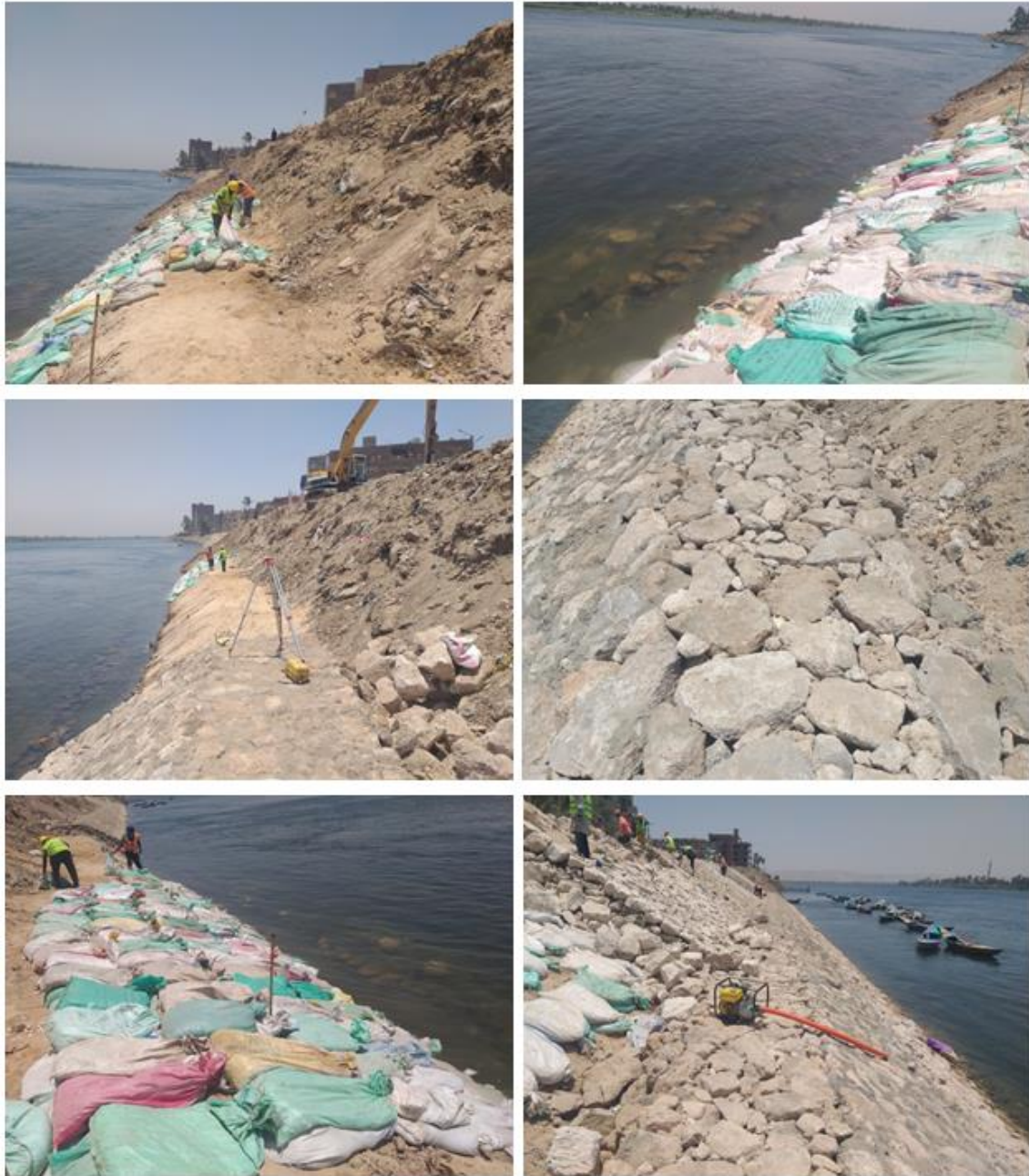
شكل (2-17): مجموعة صور فوتوغرافية للمنطقة محل الدراسة توضح إستخدام الحفار لإنزال الحجر لمناطق التدبيش (الحجر العيسوس) بحسب المواصفات الفنية لأعمال حماية جوانب نهر النيل (معهد بحوث النيل - المركز القومي لبحوث المياه - وزارة الموارد المائية والري) ، وعملية دك وإضافة طبقة عازلة من الرمال أو الحجر أسفل مناطق التدبيش ، والإلتزام بمعدات الوقاية والحماية.
