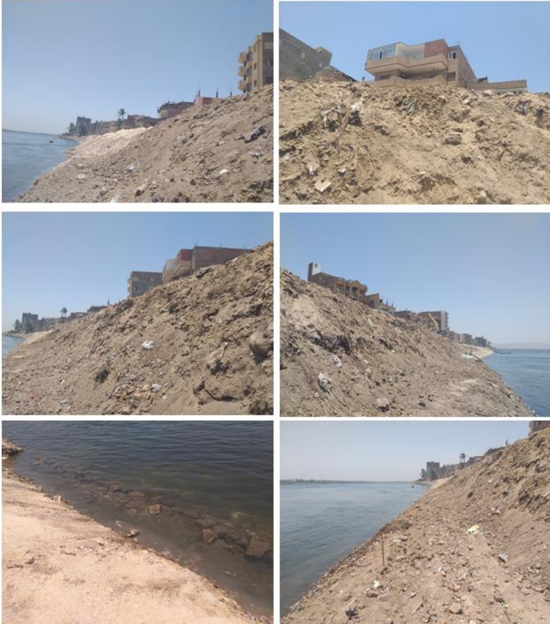
شكل (14-2): مجموعة صور فوتوغرافية للمنطقة محل الدراسة توضح إرتفاع الطريق عن خط مياه النيل بحوالي (15 - 20 م) ، كما توضح الصور شكل الميول للتربة والتي يتم تمهيدها وضبط الميول ودكها وإضافة الحصى بالمناطق التي تغمرها المياه أو إضافة الرمال بالمناطق المرتفعة بسحب كل منطقة تمهيدا لعمليات التدبير للمنطقة.
